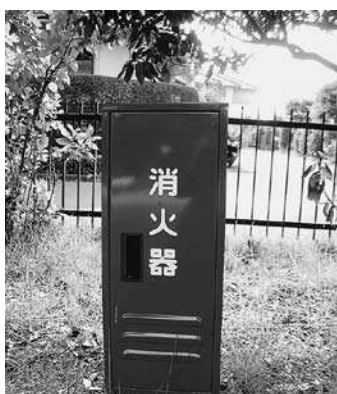
くすのき公園内消火器
