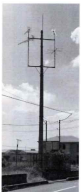
CATV 受信タワー
